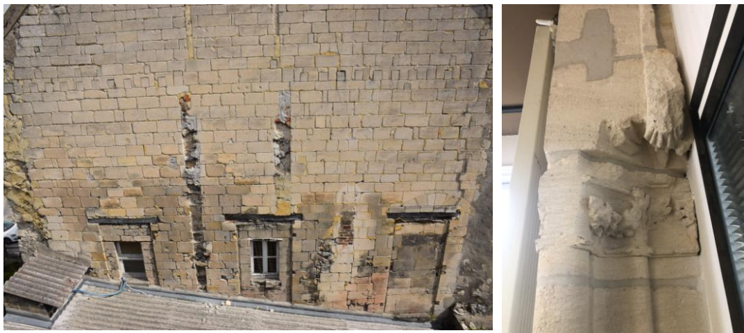
Eléments sculptés de la cheminée, 1 er étage du château, et vue du pignon intermédiaire © Musée Gallé-Juillet, Creil
